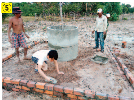
⑤ 土でパイプと穴の隙間を埋め 周りをコンクリートやレンガで固めて完成
